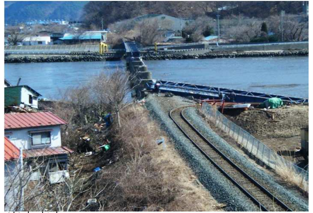
宮古市内 鉄道のレールもあらぬ方向へ捻じ曲げられてしまいました。最初から川へ向かうルートとして存在していたかのように。
