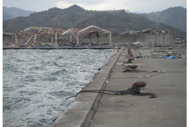
大槌町の岸壁 以前は海面から1~2メートルの高さにある岸壁が、ちょっとした波で海水が乗り越えてしまう。地盤が沈下してしまった状況。
