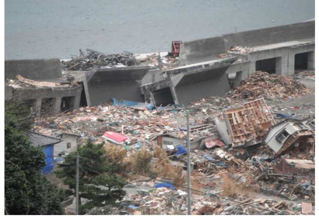
唐丹町 小白浜漁港 左側赤丸印内。こちらも壊れるはずがないと信じられていた防潮堤。防潮堤としては最新の構造なのですが、いともたやすく破壊しています。
